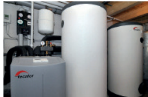
Im Hauswirtschaftsraum hielt modernste Wärmepumpentechnik von tecalor Einzug: Die Wasser/Wasser-Wärmepumpe TTW 13 sowie ein Puffer- und Warmwasserspeicher.
